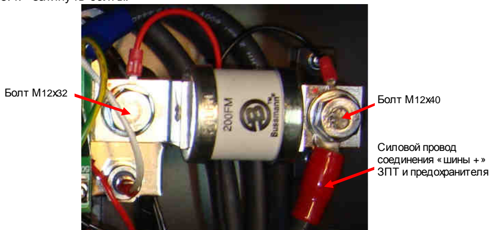
Рис. 7.22. Установка силового предохранителя.
